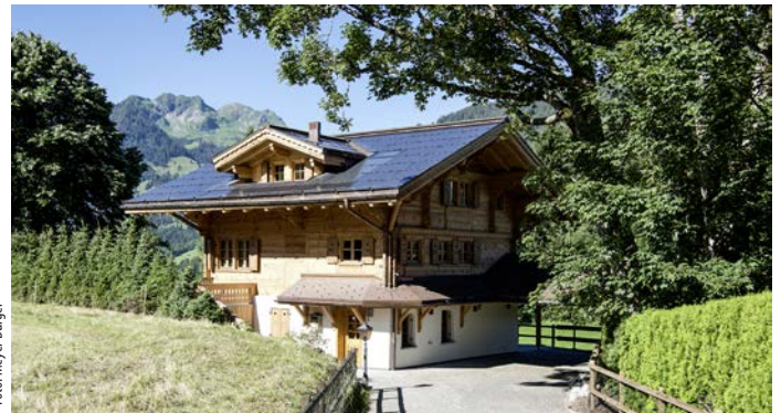
Bei der Sanierung eines Chalets in den schweizerischen Bergen kam das System Megaslate zum Einsatz. Es ist eines der meistverbauten Indachsysteme.
